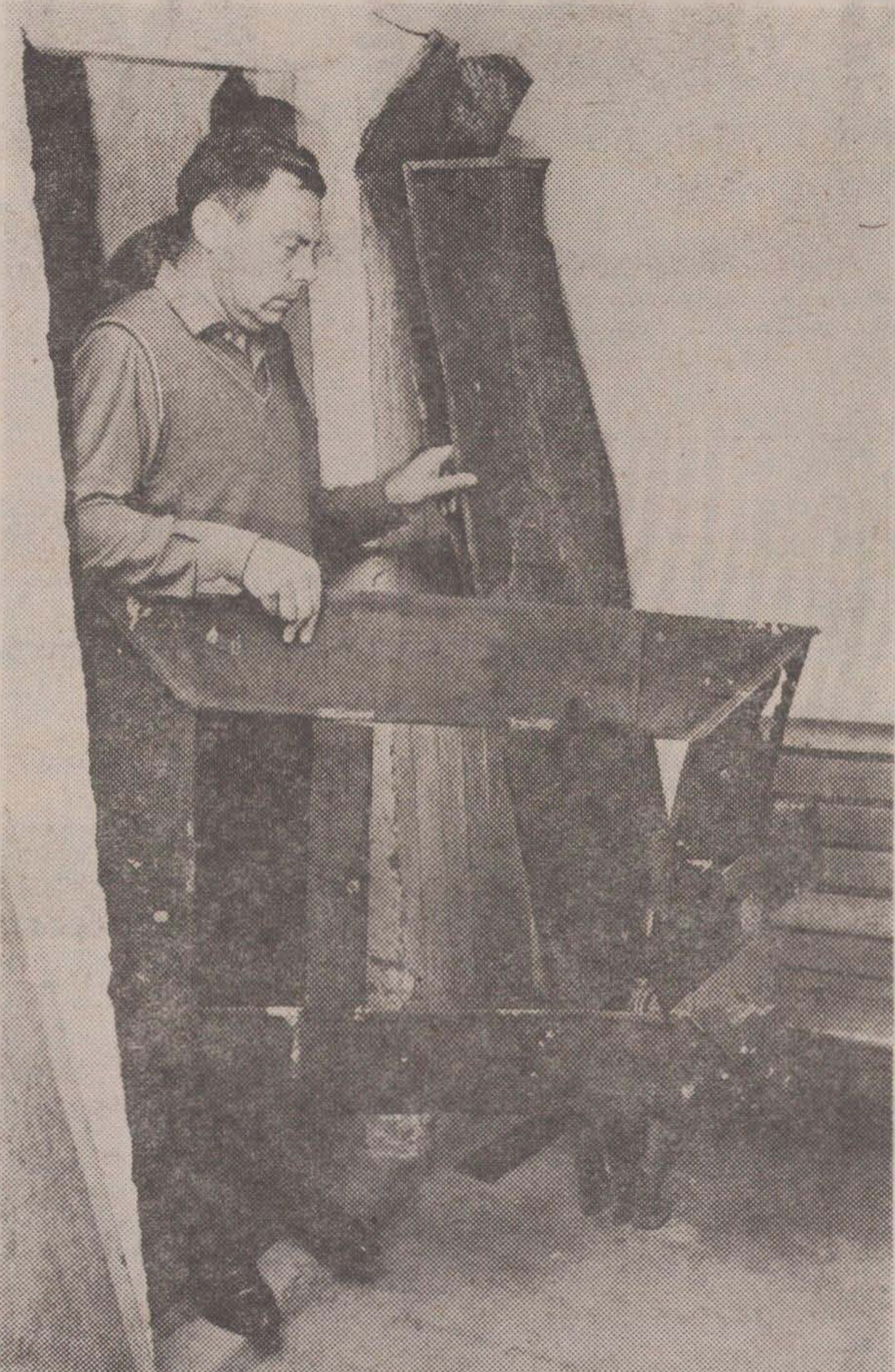
När det stormade förra hösten, blåste plåtar och tegel ner från taket. Nästan ett år senare ligger trasiga takplåtar fortfarande kvar i källaren. — Under dom här sakerna som är så farliga för ungarna, hittade vi fullt med råttor, berättar Vidar Nilsson.
